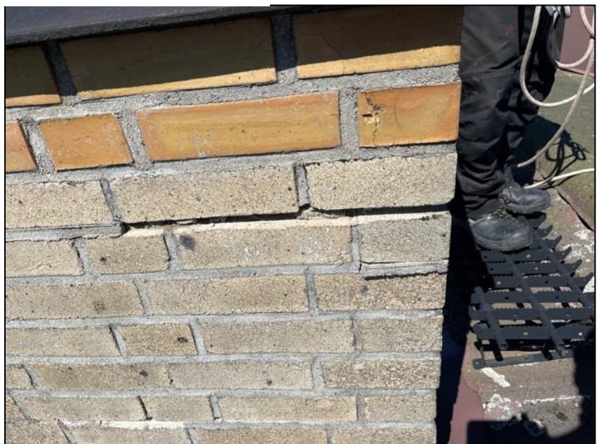
Figur 1 sprekker i fuger
